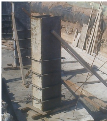
Εικόνα 1. Κλειδιά σε υποστύλωμα (Πριν)
